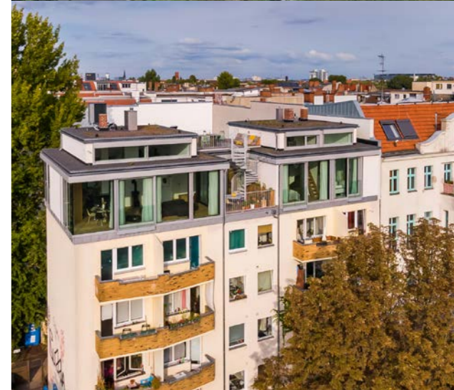
Aufstockung auf ein viergeschossiges Wohngebäude mitten in einer begehrten Metropole. Auf dem zuvor ungenutzten Dach sind 170 qm neuer Wohnraum entstanden. Argument für den Holzrahmenbau: die statischen Vorteile und der schnelle Baufortschritt ohne große Beeinträchtigung der Bewohner.
